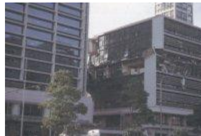
6階部分が崩壊した神戸市役所2号館
